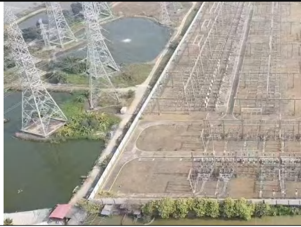
220kV浪网站扩建间隔侧
