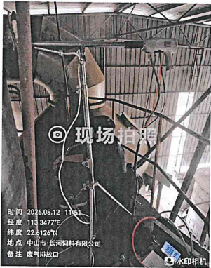
锅炉废气排放口
