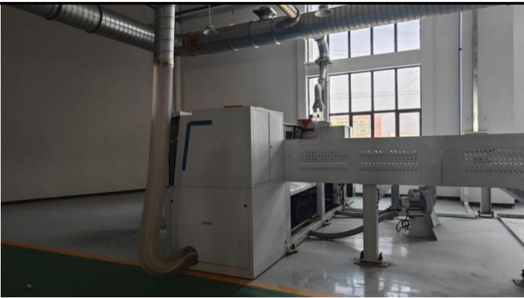
图 4-1 木工类生产设备废气管道收集示例图
